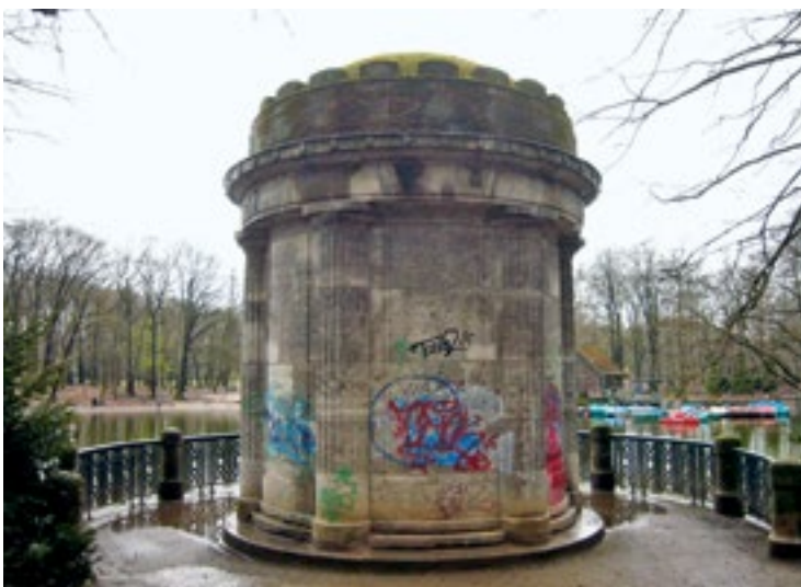
Abb. 16. Deusstempel im Stadtwald vor der Restaurierung
