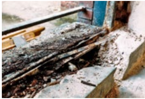
Abb. 11. Haus Lange, Fensterbankprofile nach innen mit Putzanschlüssen und völlig verrosteten Stahlteilen
