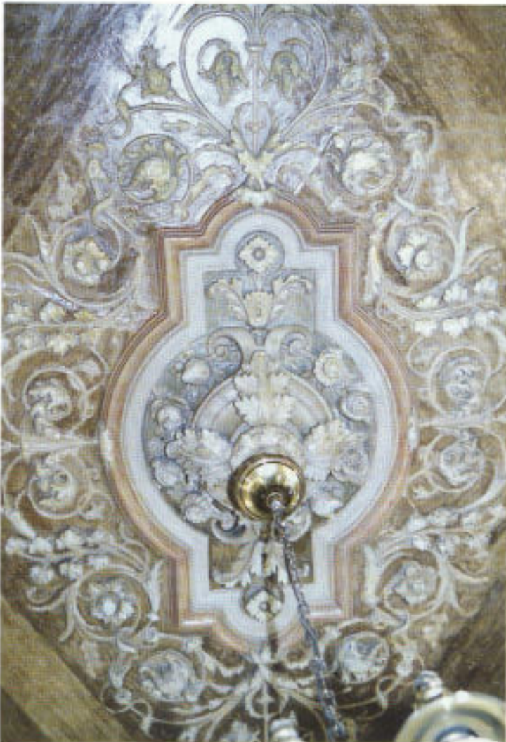
Abb. 4. Die restaurierte Mittelrosette (Detail)
