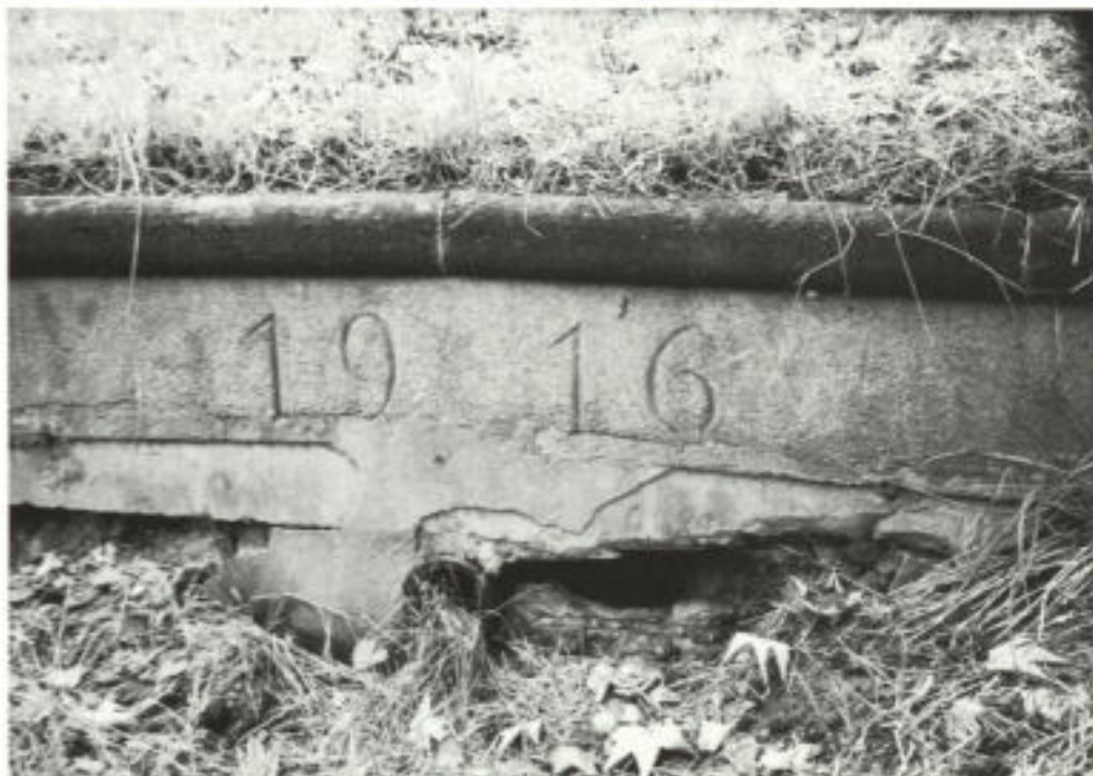
Abb. 6. Im Jahre 1916 zugemauerter Durchlaß am Grenzgraben in Richtung Stadtwald und Niepkuhlen
