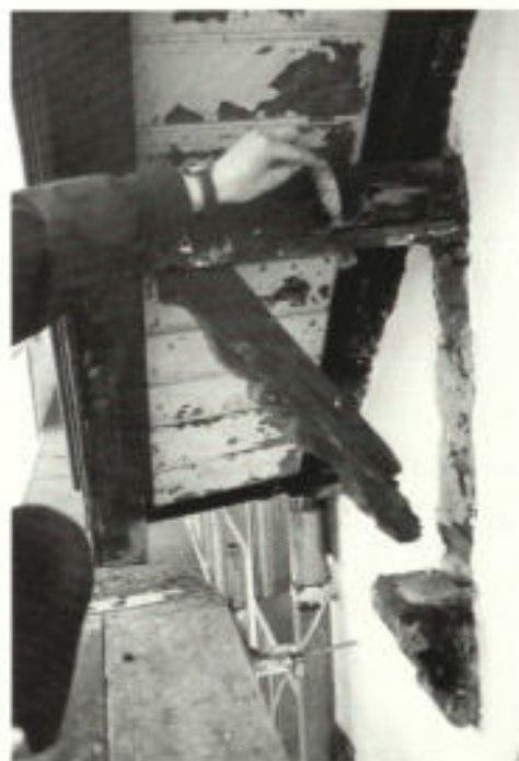
Abb. 17. Die Schäden am Holzfachwerk
