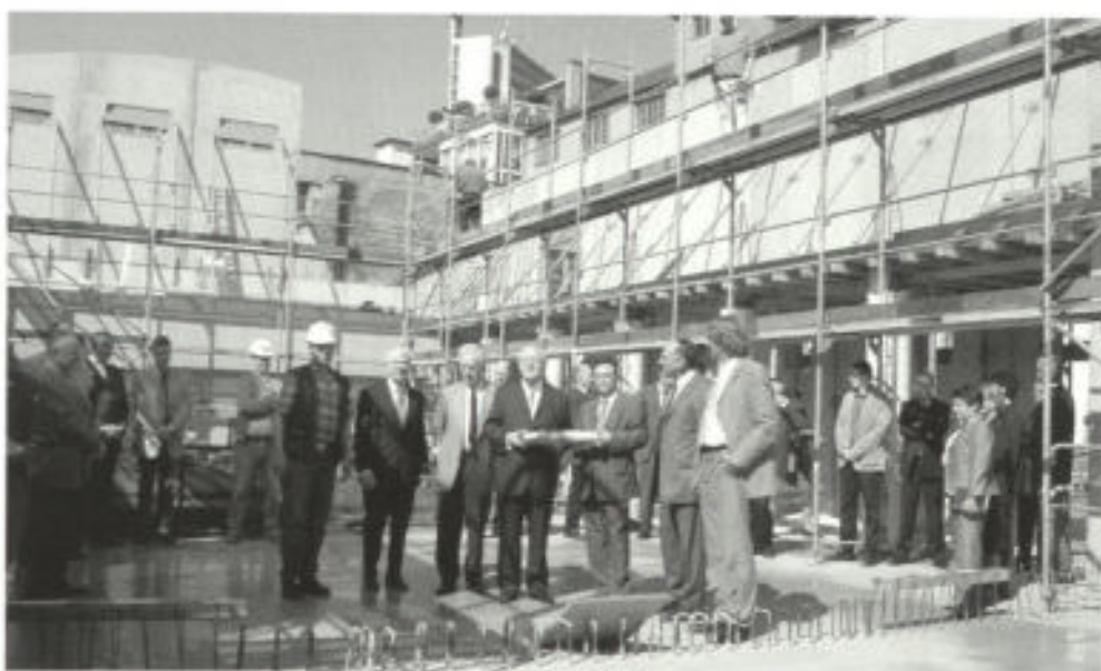
Im Hof eines ehemaligen Fabrikgeländes an der Wiedstraße entsteht die neue Synagoge. Mitglieder der jüdischen Gemeinde und der Dr.-Hirschfelder-Stiftung haben sich mit den Bauleuten zur Grundsteinlegung eingefunden.
